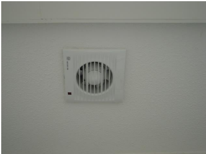
Ventilator in plafond, met afvoerkanaal op het dak
