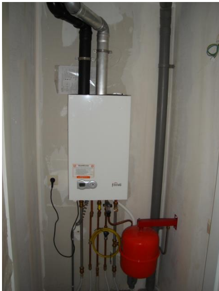
HR-combiketel. Het rode vat is een expansievat.
