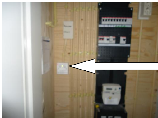
Bedieningsknop in meterkast
