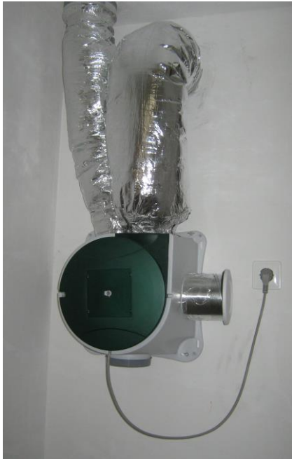
Unit mechanische ventilatie
