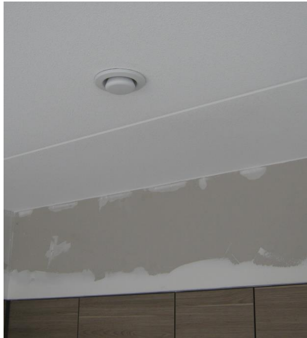
Ventiel mechanische ventilatie
