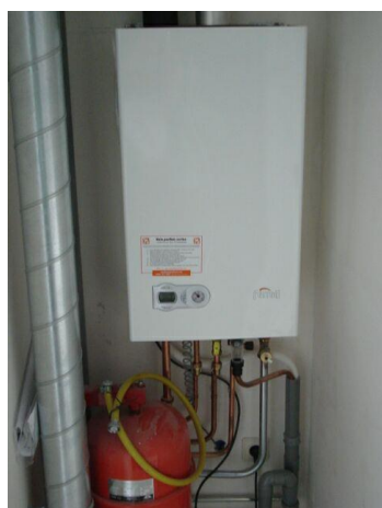
Fig.: 5.1.1. Rechtsboven de centrale verwarming. Linksboven de boiler.
